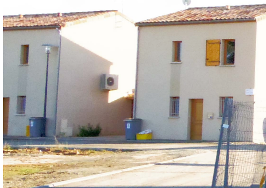
Un boîtier de ventilation qui ressemble à une climatisation (source images : LET, 2013)
